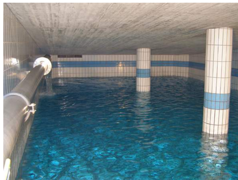
Wasserkammer eines Trinkwasserspeichers
