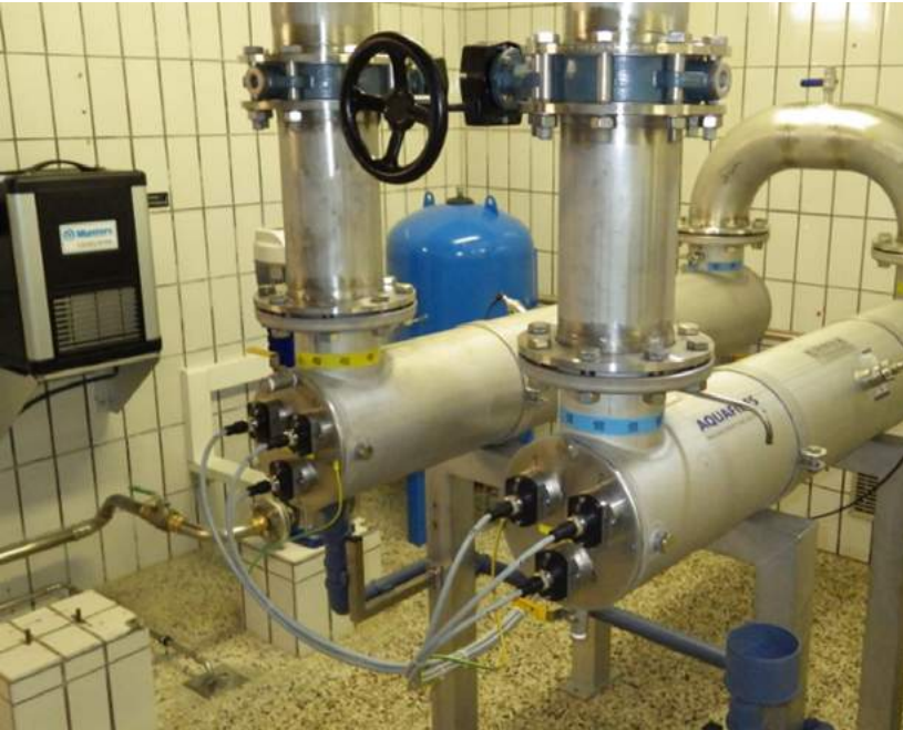
UV-Anlage zur Trinkwasserdesinfektion
